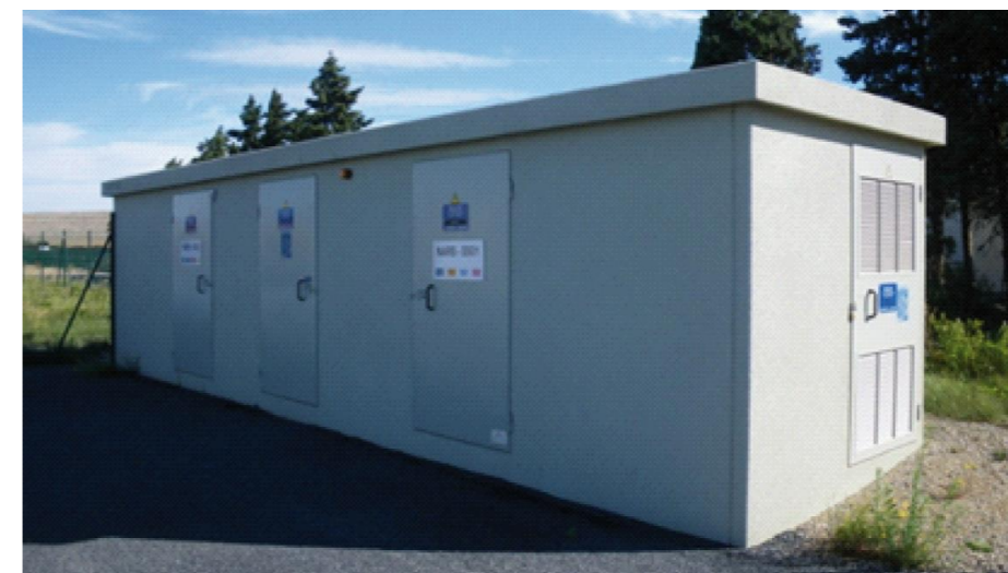
Photo 5 : Exemple d'un poste de livraison
