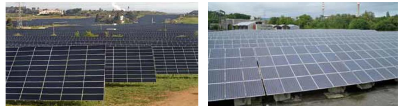
Photo 2 : installations fixes au sol
